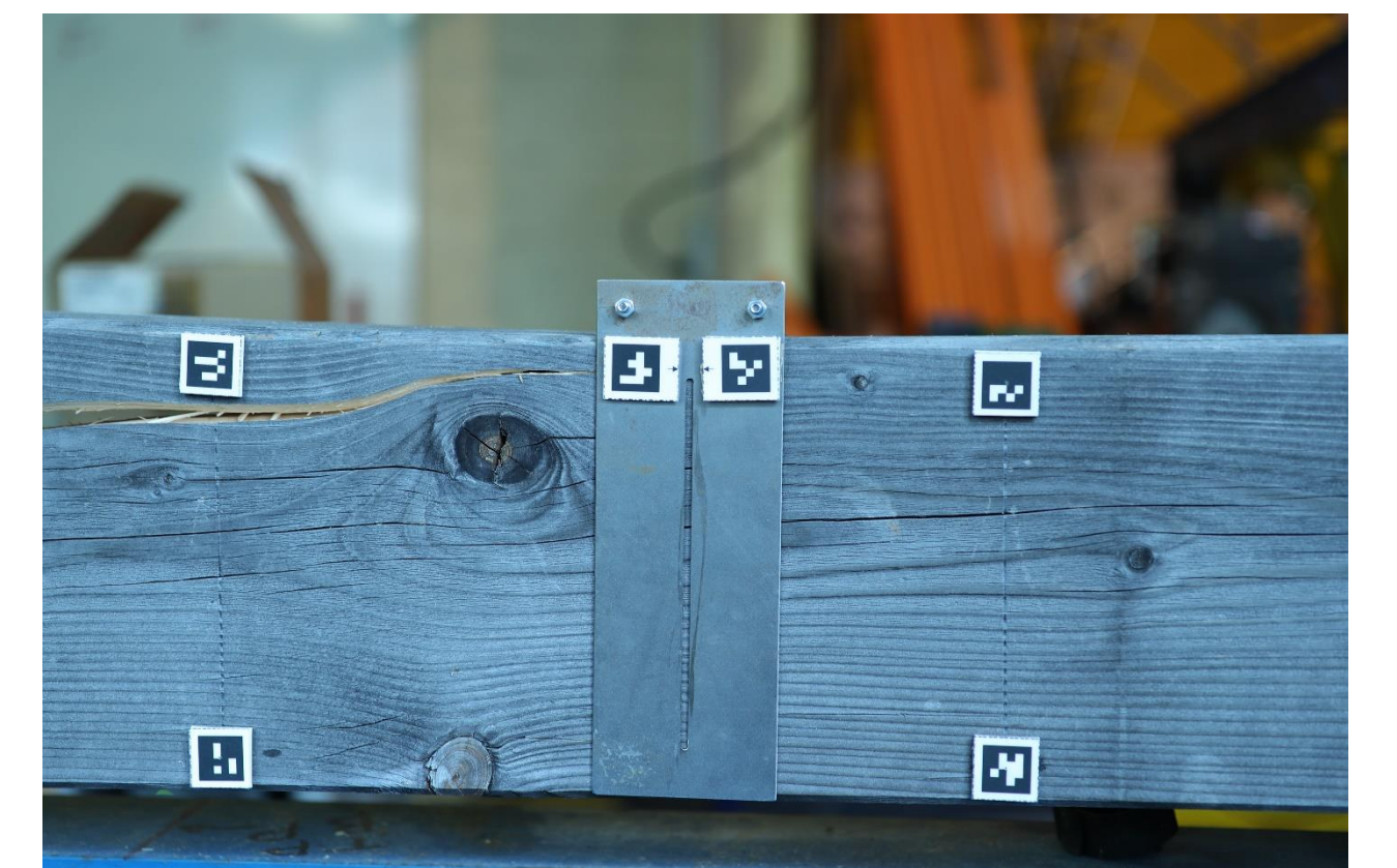
Fig. 6 : Mesure de la longueur et la hauteur de fissure
