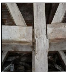
Fig. 3 : Rupture des clefs dans l'assemblage tenon-mortaise entre poteau et poutre
