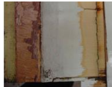
Figure 80 : Détail d'une crique sur un longeron de CAP231 (photo Air Menuiserie).
